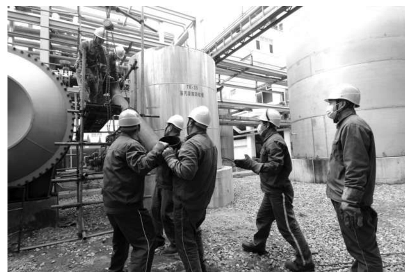
近日,瑞安恒通化工公司树脂厂更换了使用已久、换热板损坏的1号聚合1号母液换热器,提高了换热效果,满足了母液处理所需母液温度,提高了厂区环保管理水平,确保了树脂厂生产装置稳定运行。
